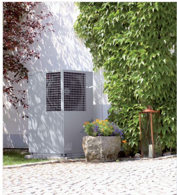
Abb. 5.3: Luft/Wasser-Wärmepumpe in Außenaufstellung
