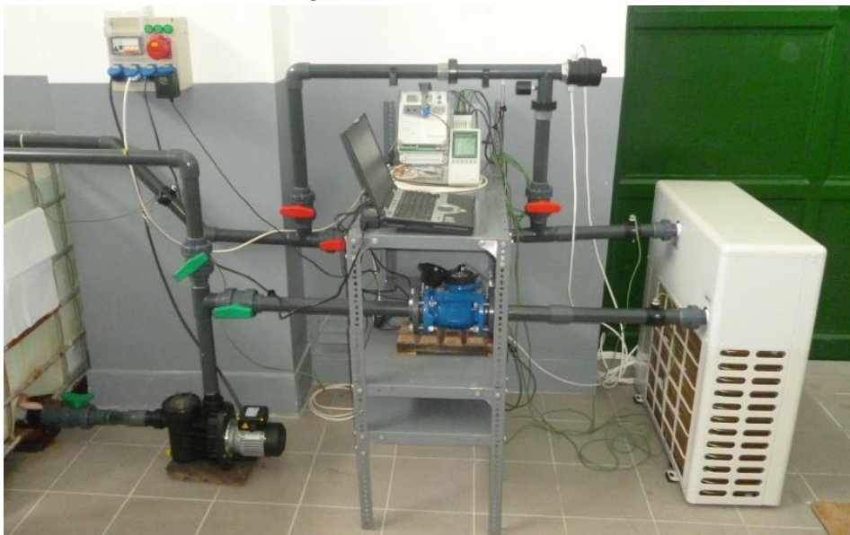
Abb. 3. Wärmepumpen-Messkreis an der Universität Szent István, Fakultät für Maschinenbau
